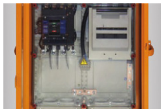
Grand espace de raccordement
